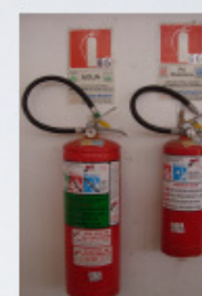
EXTINTORES EM TODO COMPLEXO
