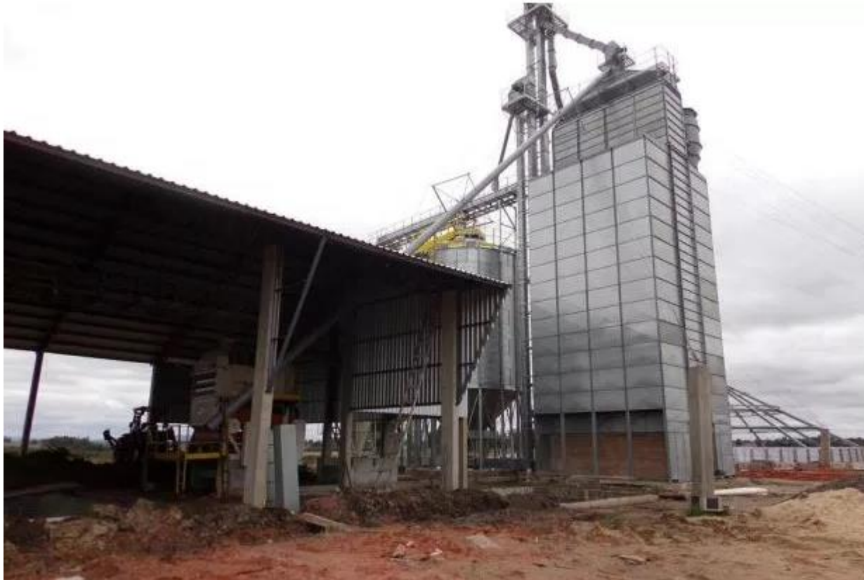
Acidente aconteceu na obra à margem da RS-241 em São Vicente do Sul, e vitimou trabalhador de 22 anos
