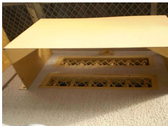
Vista da iluminação e ventilação externa das celas
