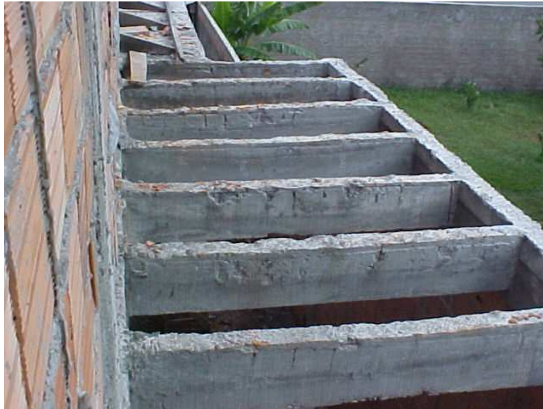
Ejecución deficiente (Geyer e Brandão, 2007)
