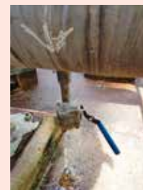
Figura 6. Ausência de resfriador
