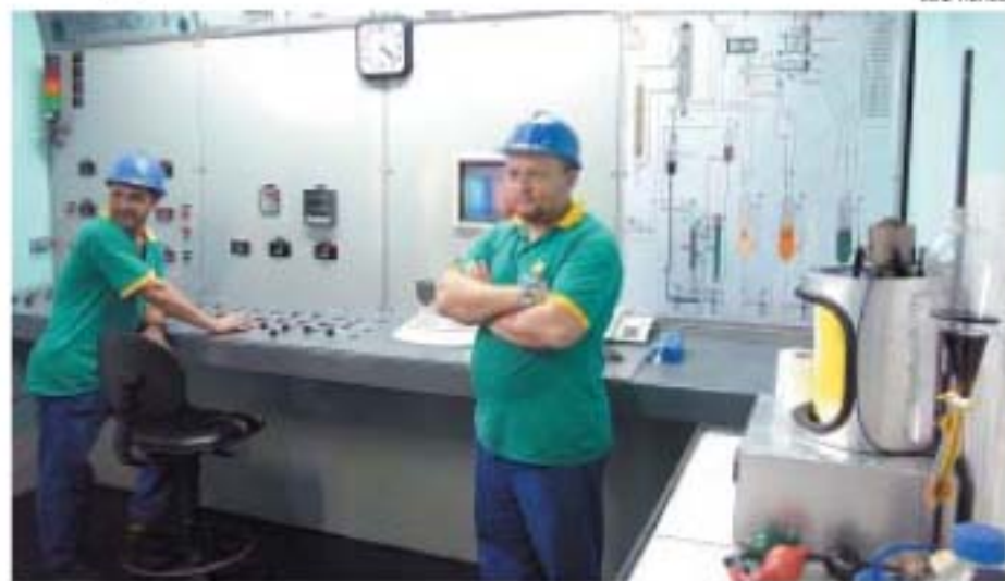
A sala de controle, que monitora todo o processo de reciclagem
