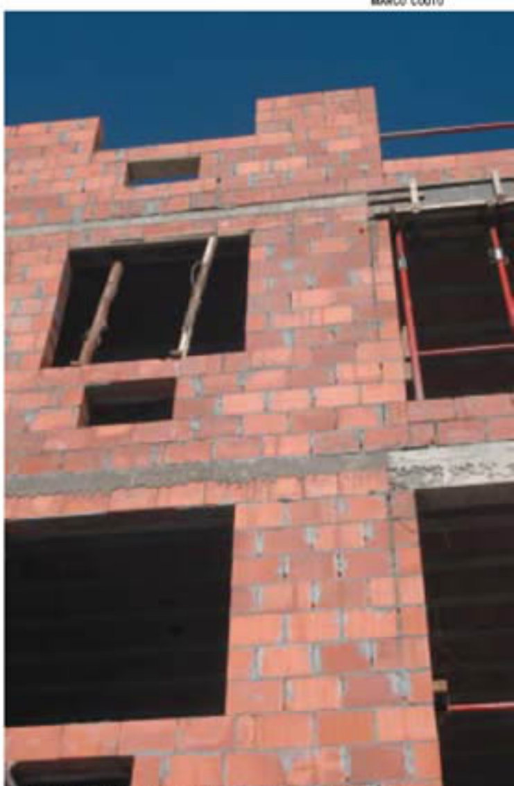
Uma das causas está na pouca espessura das paredes. A escolha correta dos materiais também é fundamental
