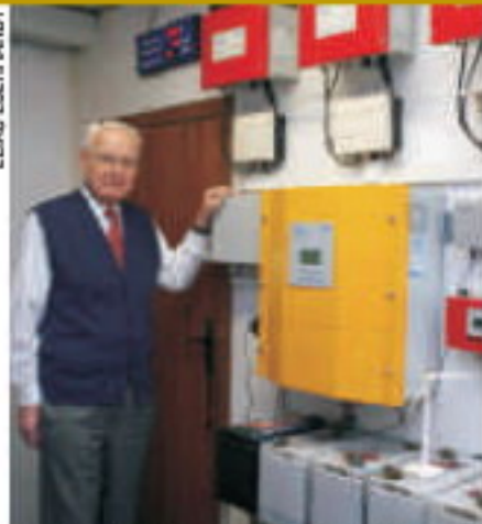
Hans Rahn ao lado de inversores que convertem corrente contínua em alternada, para a injeção direta na rede elétrica
