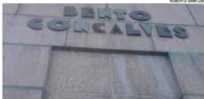
Monumento a Bento Gonçalves: as “fascinas” corroeram os pinos de fixação das placas e das letras de bronze
