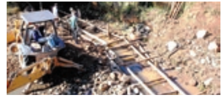
2. Início da obra, com a construção de uma palificada dupla para a estruturação da base
