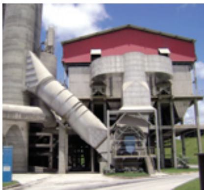
Equipamento filtro de mangas grande, 8000 mangas, Cimesa, Aracaju (SE)
