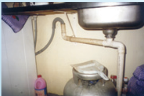
Instalações de esgoto feitas pelo usuário para instalação de máquina de lavar roupas. Fonte: Canto (2002)
