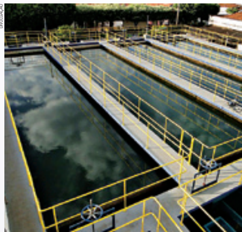
Estação de Tratamento de Água
