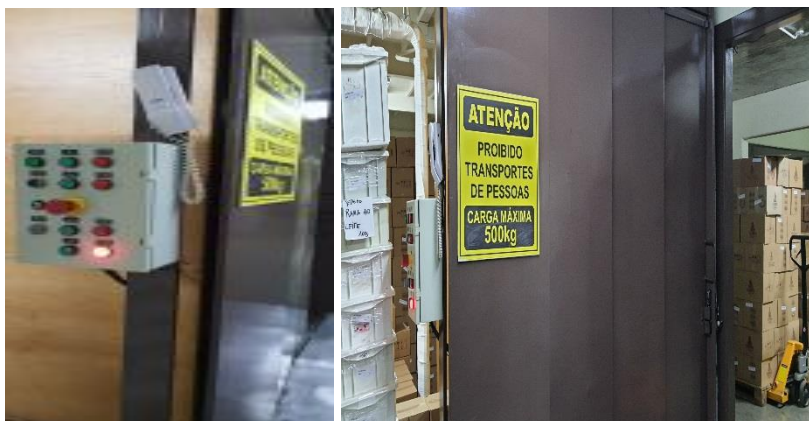
Inspeção realizada em elevador de carga após a visita do agente fiscal
